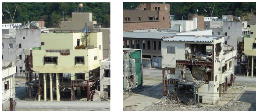
図1 津波による特徴的な建物被害の例 (筆者らが女川町において2011年7月10日撮影)
