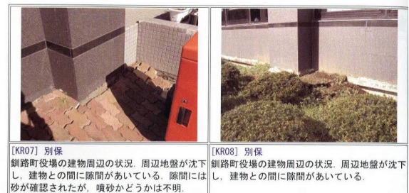
図-4 釧路町役場の被害写真 13)
