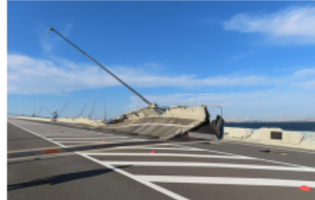
箱桁橋部分床版のめくれ上がり②
