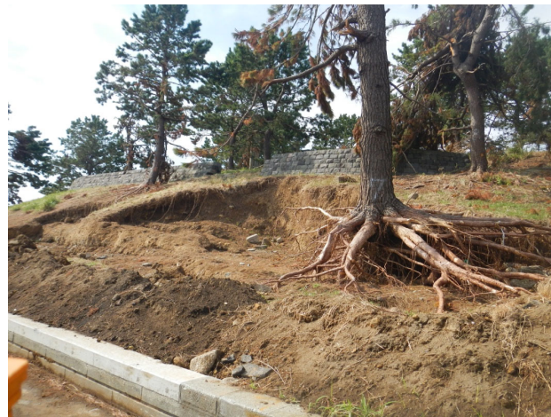
図-4.1.2.4 築山の斜面の洗掘の様子
