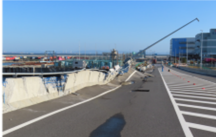
箱桁橋部分床版のめくれ上がり①
