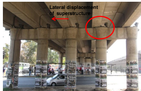
(d) Damage of eastbound Independencia overpass
