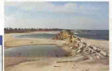
▲ 山元町 海岸堤防被災状況
